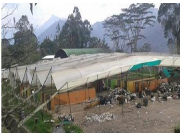
Estado actual cubierta PMIRS
